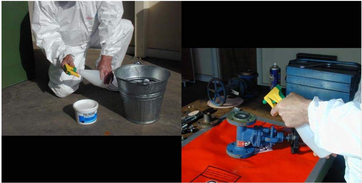
Abb. 11.4 Die Asbestdichtung auf einem Ventil wird angefeuchtet
