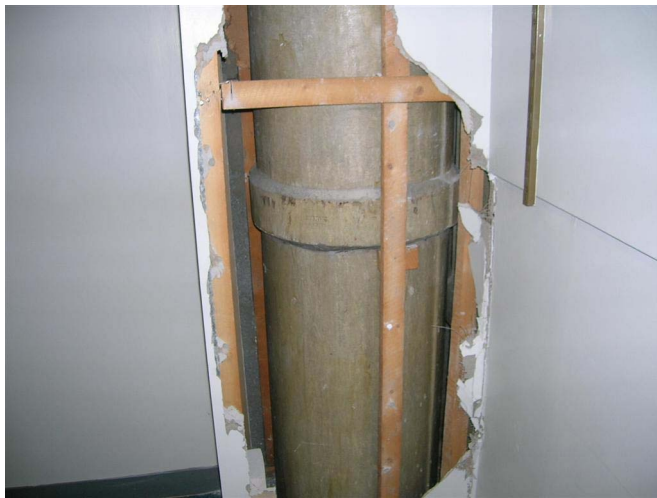
Abb. 4.2 Einschließung mit Asbest-Isolierplatte (teilweise entfernt, um das dahinter liegende Asbestzement-Abgasrohr zu zeigen)
